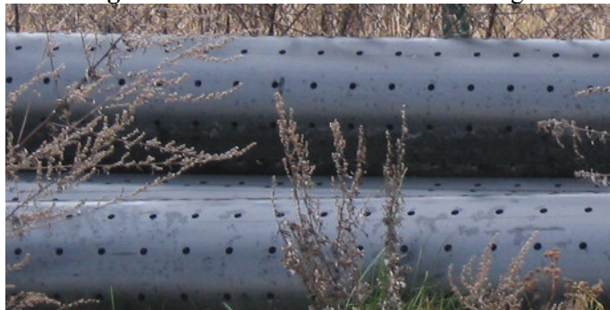
Figura 5. Vedere tevi de colectare a levigatului
