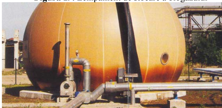
Figura 19. Echipament de stocare a biogazului
